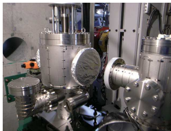
図3 新しく設置されたビームシャッター槽。電子ビーム入射時の散乱された放射線が実験ホールに漏れだすのを防ぐために中に 200mm(W)×80mm(H)×150 mm(t)のヘビーメタルが設置されている。
