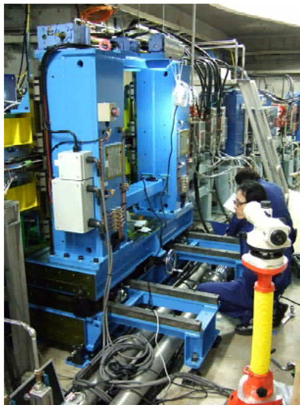
図2. 設置作業中のアンジュレータ。水冷パイプを跨いだ架台上にアンジュレータが設置されており、前後に移動できる構造となっている。
